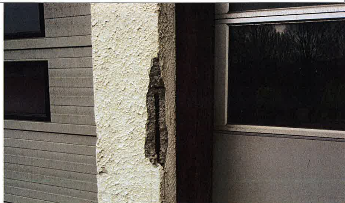
Bilde nr:2- 6. Bygningsdel/lokalisering: Porter nordfasade hovedbygg Kommentarer: Synlig korrodert armering på søyle.
