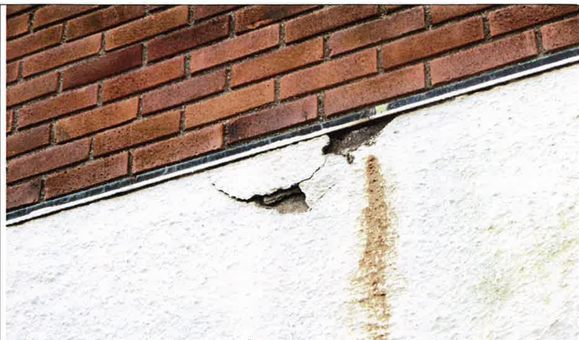
Bilde nr: 2-5. Bygningsdel/lokalisering: Nordfasade, over østre port. Kommentarer: Avskallet betong.
