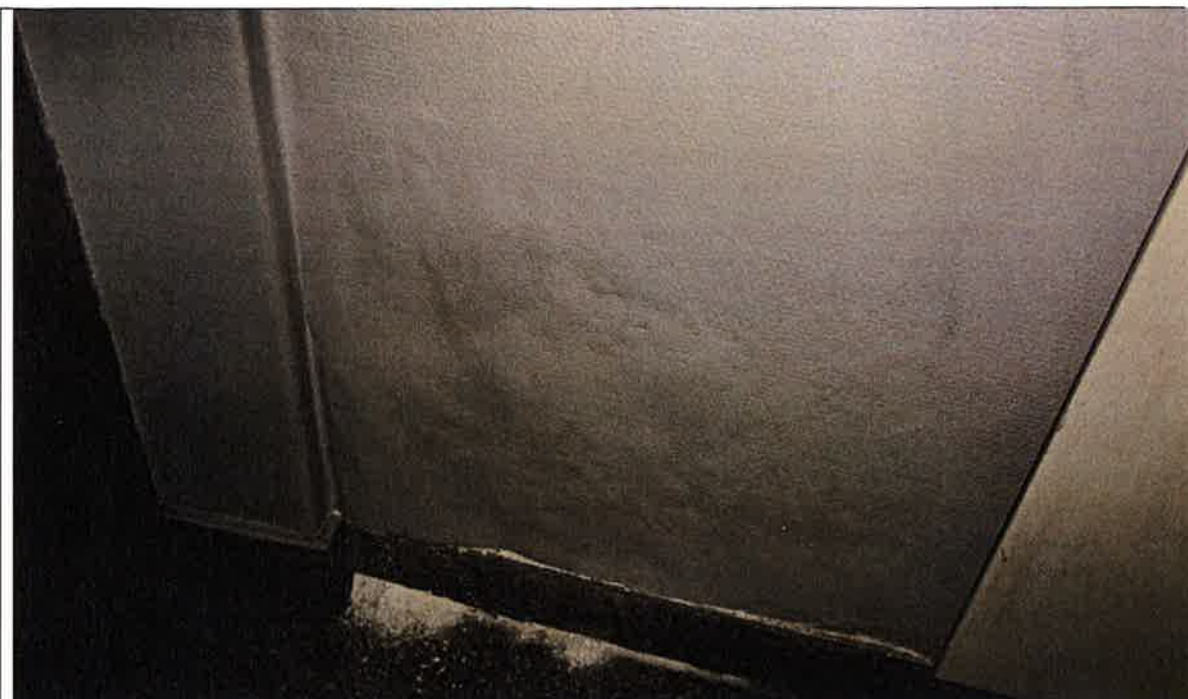
Bilde nr: 2-33 Bygningsdel/lokalisering: Trapperom 2. etasje. Kommentarer: Saltutslag og fukt fra vanninntrenging i yttervegg ovenfra.
