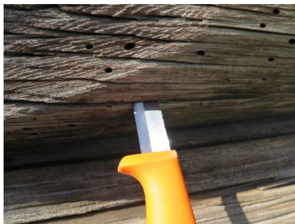
Foto 8. Det kan oppstå omfattende svekkelse av de indre delene av treverket før skadene oppdages.
