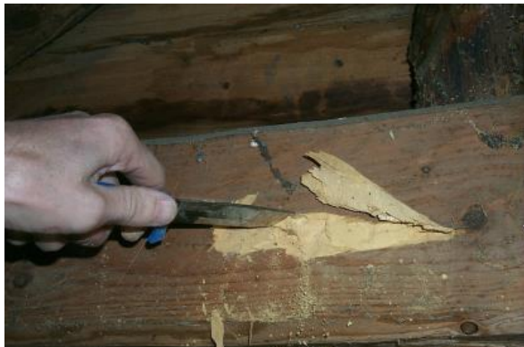
Foto 1. Husbukken forårsaker svekkelse av treverk.
