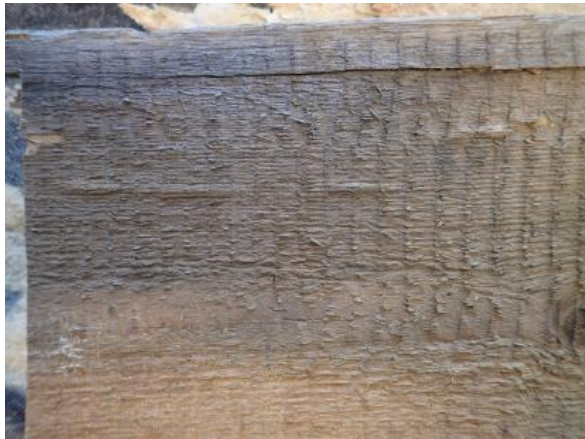
Foto 11. Angrep rett under overflaten kan oppdages ved at det tynne overflatesjiktet buler noe ut på grunn av det tettpakkede boremelet i larvegangene.
