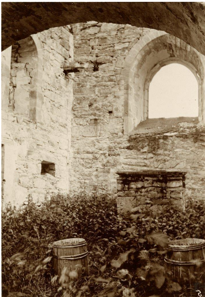
Figur 10 Korets interiør etter rivingen av taket. Også pussen på innerveggen forfalt raskt. Foto: Riksantikvaren.
