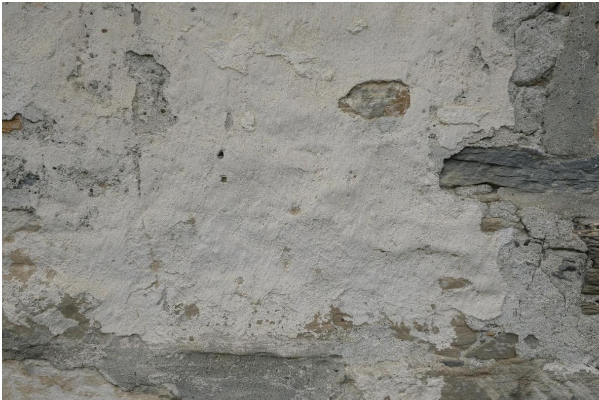
Figur 13 Detalj fra pussen. Muren har meddratte fuger og et tynt pusslag ut over steinene. På dette er det gjennom årene påført flere lag med kalkhvitting.
