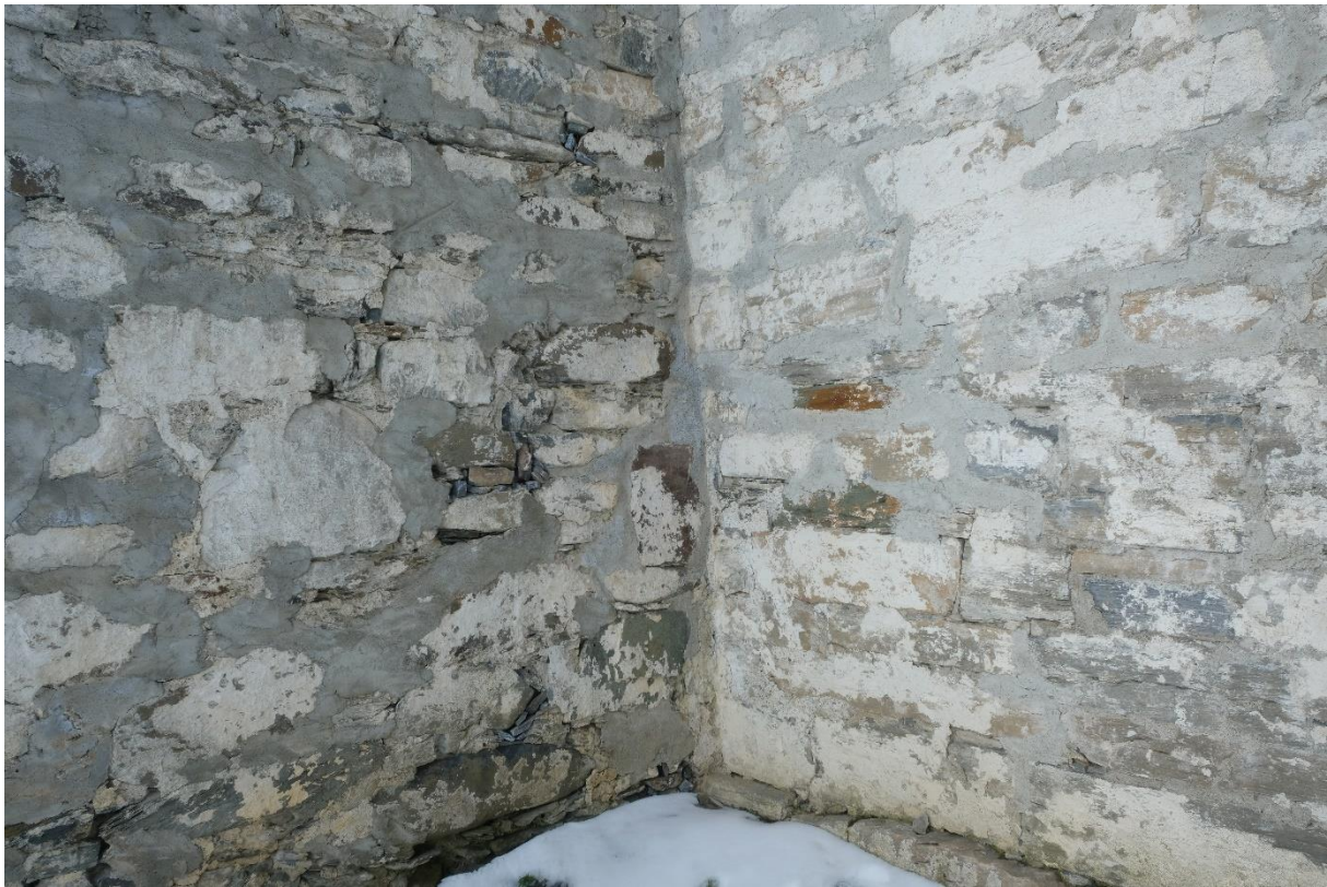
Figur 15 Hjørne mellom støttepilar og sørmur. Bildet viser at pilarene også har vært kalkhvittet.
