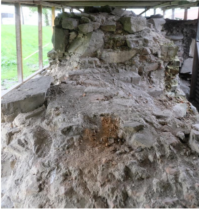
Figur 20 Middelalderens kirkemurer kalles kistemur fordi de har to murvanger som veggene i en kiste med en murkjerne inni. Murkjernen er av kalk og er vesentlig for murens styrke og stabilitet. God fuktvandring som gjør at kalken i kjernen ikke står fuktig over tid og løses opp er avgjørende. Det er funksjonen til en god puss og ta i mot og fordele fukt fra regnet og gi en stor overflate for opptørking. Pussen beskytter på den måten murkjernen. Foto fra Bispegården i Oslo
