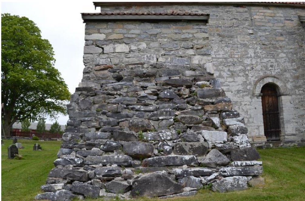
Figur 2 Svært åpent murverk på vestre støttepilar er en viktig del av bakgrunnen for de planlagte arbeidene. Foto: Sakshaug gamle kirke - Tilstandsvurdering av støttemurer - Bakken og Magnussen AS 2018.
