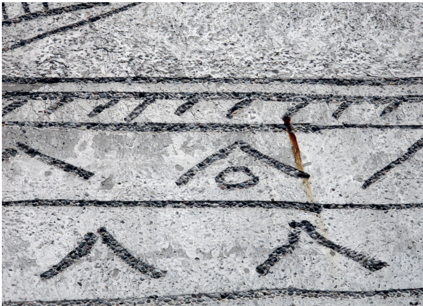
Detalj av Picassos «Fiskerne» på Y-blokka. Rusten skyldes en jernholdig stein i overflata og utgjør ingen fare. Foto: Siri Hoem
